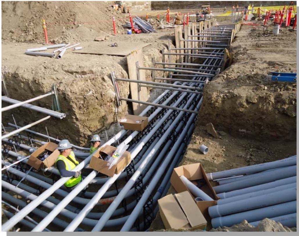
Underground Electrical Conduit
